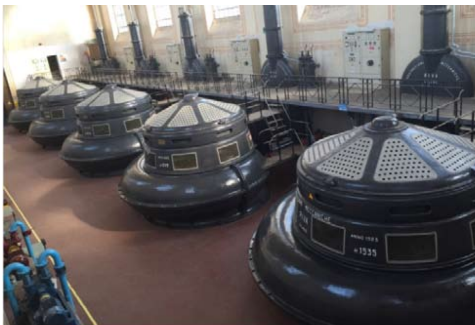
Dettaglio sala macchine: pompe Riva del 1925 ancora funzionanti. Detail of engine room: still functioning 1925 Riva pumps.
