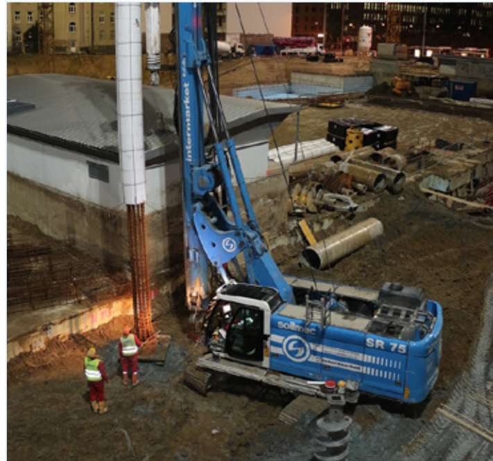
Perforatrice Soilmec SR-75 dotata di DMS in azione in pieno centro di Vienna per il progetto "Trienna" - Austria
