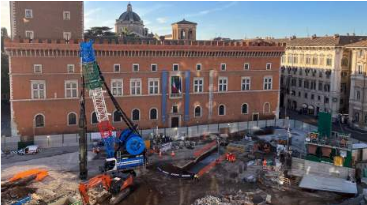
Idrofresa Soilmec SC-130 Tiger in cantiere a Piazza Venezia, Metro Linea C | Roma, Italia
